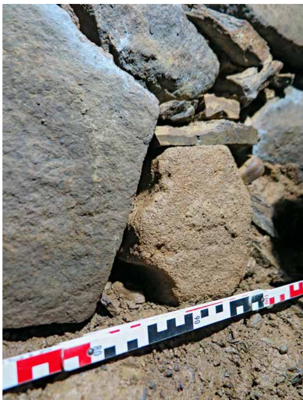
Obr. 29. Plasy, klášter, štola Q. Užití architektonických článků – detail gotického žebra ve zdivu první části boční štoly Q2. (Foto T. Karel, 2018)
