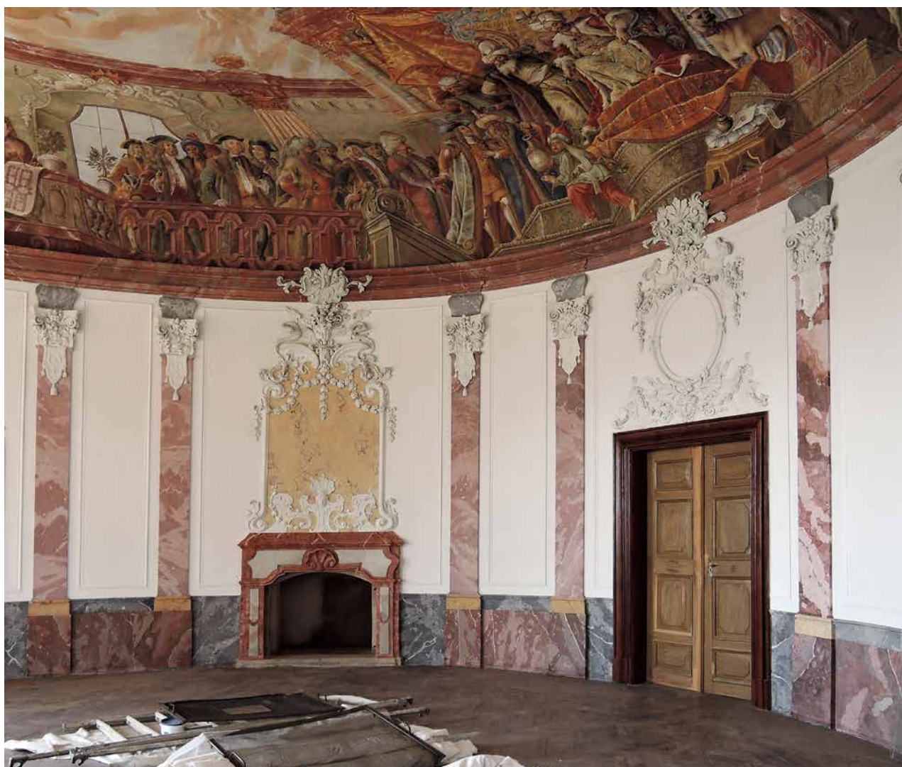
Obr. 6. Trpísty (okr. Tachov), zámek, tzv. Velký sál po obnově. (Foto P. Danda, 2016)
