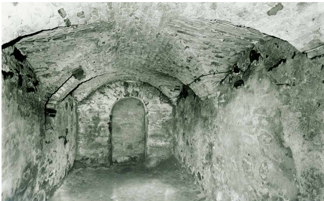
Obr. 3. Plasy, klášter, štola Q. Suterén patrové Královské kaple, pohled na zazděný otvor v západní stěně. (Fotodokumentace pro stavebně historický průzkum, SÚRPMO, 1980)
