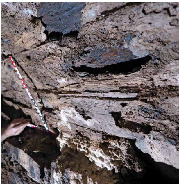
Obr. 27. Plasy, klášter, štola Q. Klenba chodby mezi šachtami Š2 a Š3 s dochovanými otisky po dřevěném šalování. (Foto M. Kohnáš, 2018)
